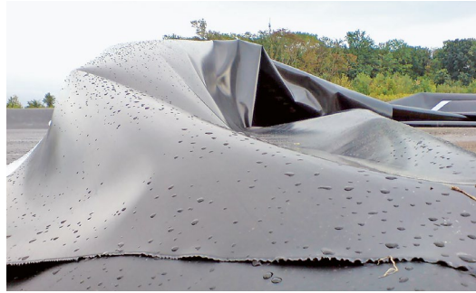
Bild 10: Schäden an Kunststoffdichtungsbahnen durch Unwettereinflüsse in der Bauphase
