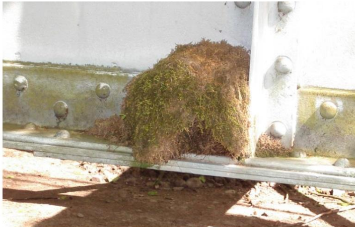
Nest an einer Stahlbrücke:
